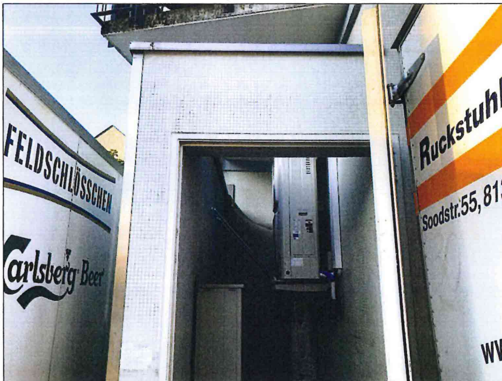
Abbildung 1 - Gerät VI-VRF-S315AREHDA3 für die Referenzmessung in Adliswil
