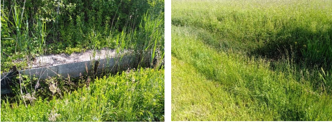
Abbildung 20: Der Nänikerbach im Projektabschnitt. Links: mit „Hobbyverbau“ (Schalttafeln und Margerbeton), rechts: fehlende Riedvegetation beidseitig vom Bach, hohe Ufer/eingetiefter Bach.
