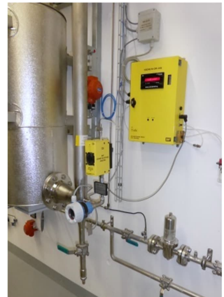
Abbildung 24: Restozonvernichter (Bild: ARA Neugut, Dübendorf)
