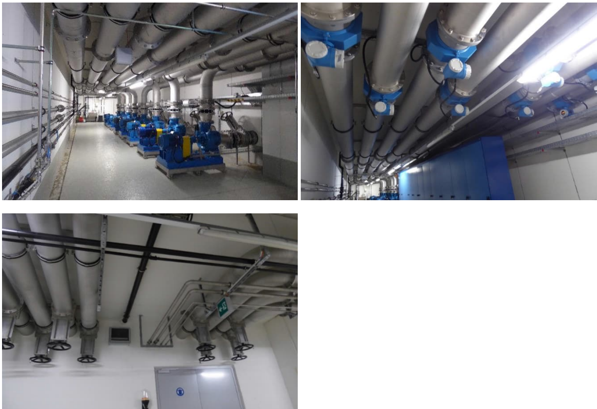
Abbildung 8: Pumpwerk SBR: Pumpen (oben links), Durchflussmessungen und Schaltschränke (oben rechts) und Handschieber im Zulauf zu den Verteilkanälen (unten)
