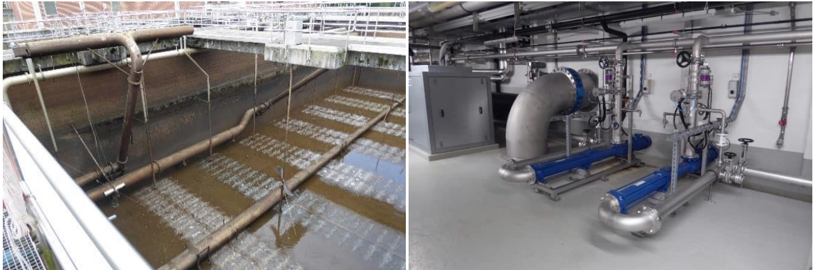
Abbildung 16: Leerer SBR (links), Technikraum zwischen den SBR mit Gebläse, Zulaufleitung und ÜSS-Pumpen (rechts)
