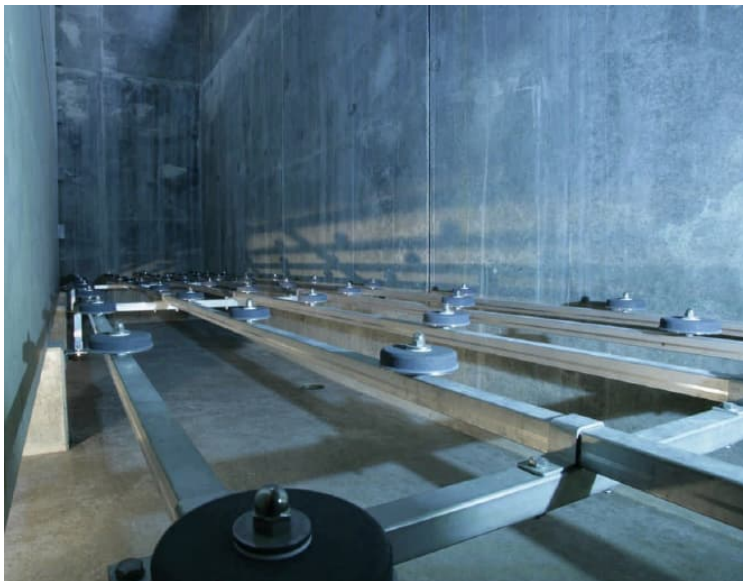
Abbildung 23: Beispiel eines Ozoneintragungssystem (Bild: ARA Neugut, Dübendorf)
