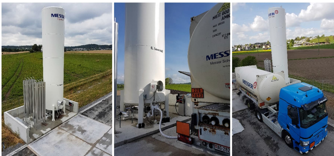
Abbildung 18: Beispiel eines Flüssigsauerstofftanks mit Verdampfern; Befüllungsvorgang (Bilder: ARA Bassersdorf)
