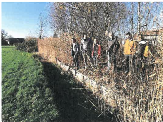
Abbildung 3: Gewässerverbauung entlang Kat.-Nr. E3527. 14. Mai 2020
